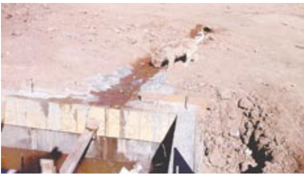
Sufren derramen de aguas negras en la calle Sonora en la colonia Plan Libertador.
