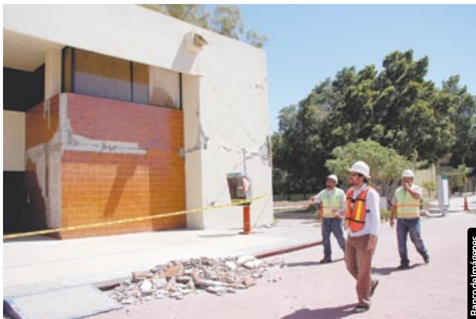
La UABC, campus Mexicali, sufrió daños por el sismo del 4 de abril de 2010.
